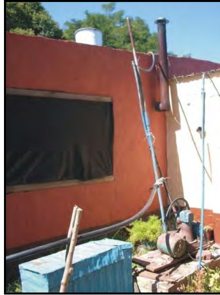
Figura 72. Cañerías de distribución de agua.
