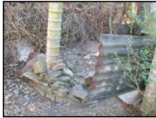
Figura 76. Cobertura deficiente de un pozo absorbente.
