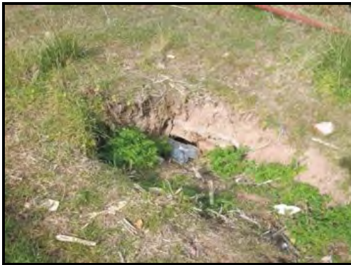
Figura 75. Pozo absorbente con evidencias de desmoronamiento.
