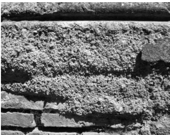
Figura 8: Detalle de un revoque grueso en una antigua bóveda del Cementerio Municipal. Nótese la textura gruesa de los componentes similares a aquellos representados en la Figura 6 y Figura 7.
