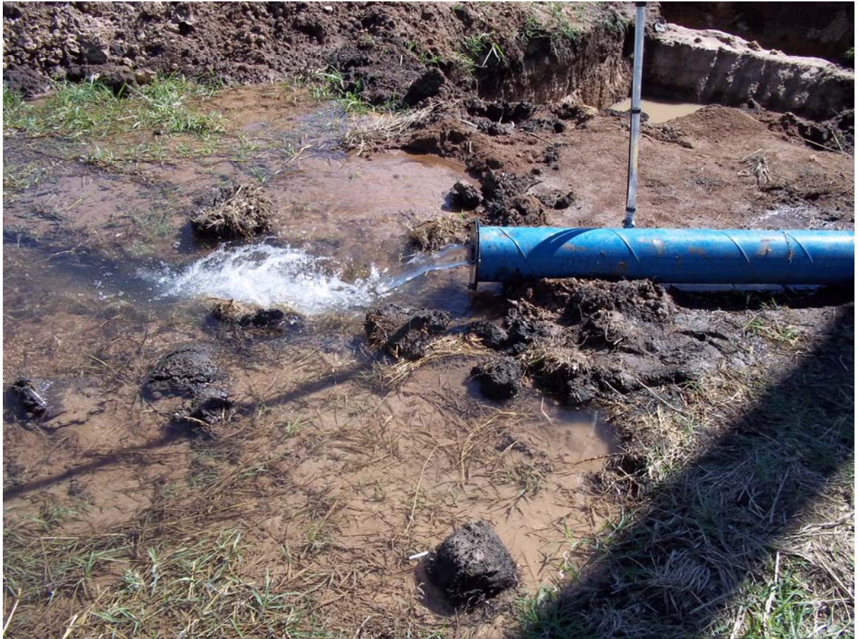
Pozo de Producción DLC1 – Fotografía registrada durante el ensayo de bombeo del pozo de producción ya finalizado.
