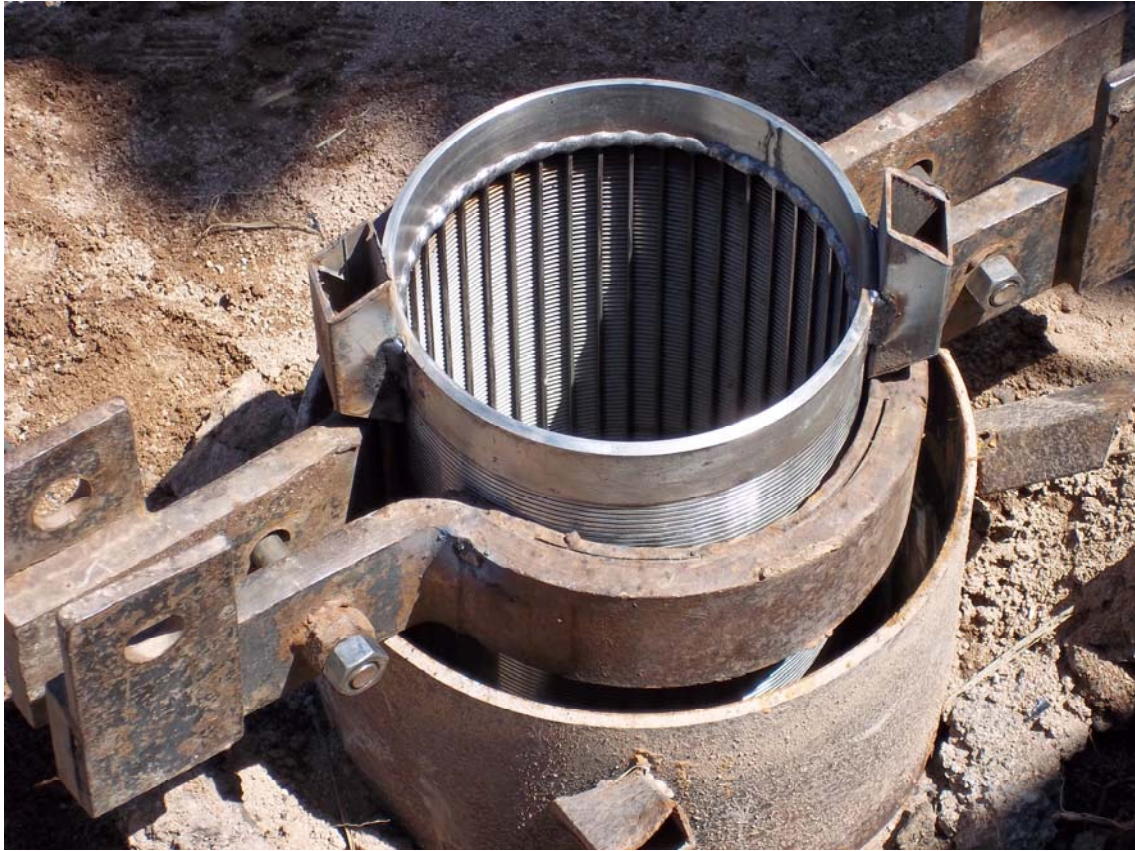
Pozo de Producción DLC1 – Detalle del área filtrante instalada de acero inoxidable una vez ejecutada la camisa de aislación de acero.
