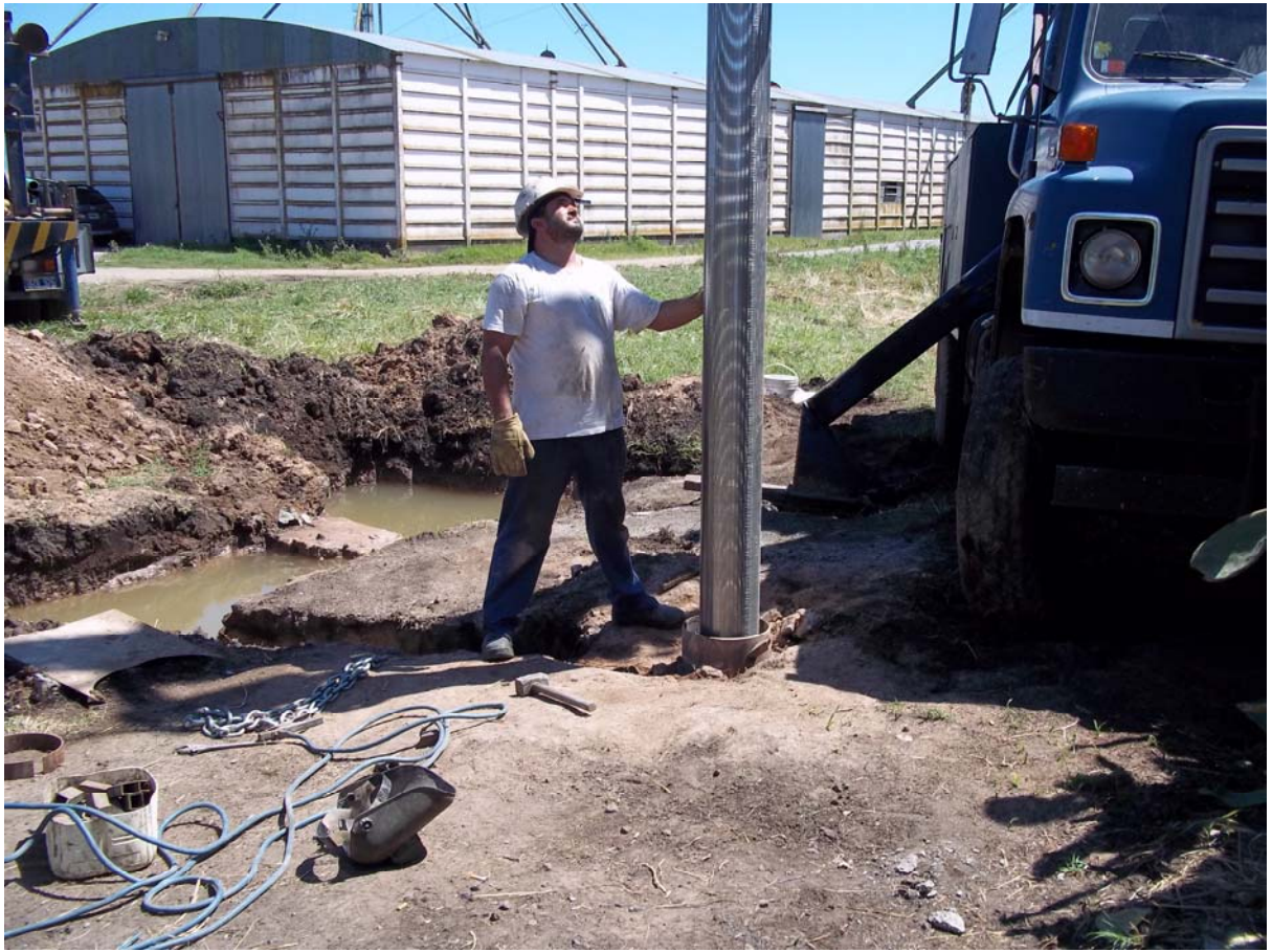
Pozo de Producción DLC1 - Vista general de los filtros de diámetro 8", de acero inoxidable.
