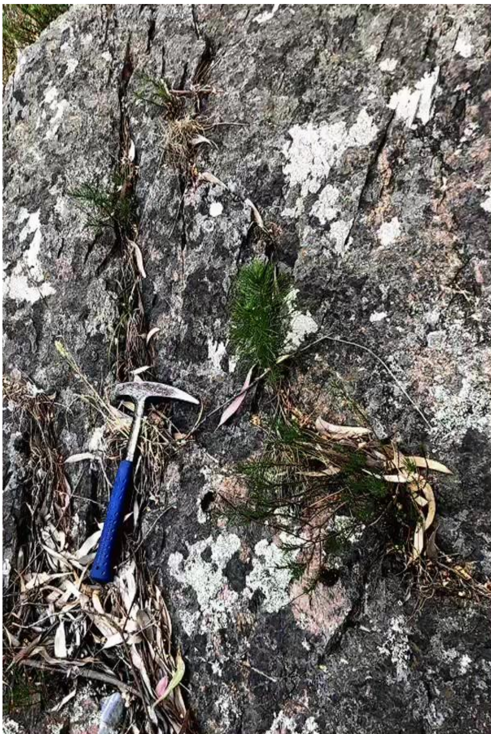
Figura 29.- Detalle del macizo rocoso de la margen derecha de la presa. Se observan diaclasas en varias direcciones, muchas de ellas enmascaradas por la vegetación. En el sector superior derecho se reconocen diaclasas poco espaciadas correspondientes al set 3. Se visualiza también la patinas de líquenes y la meteorización catafilar.
