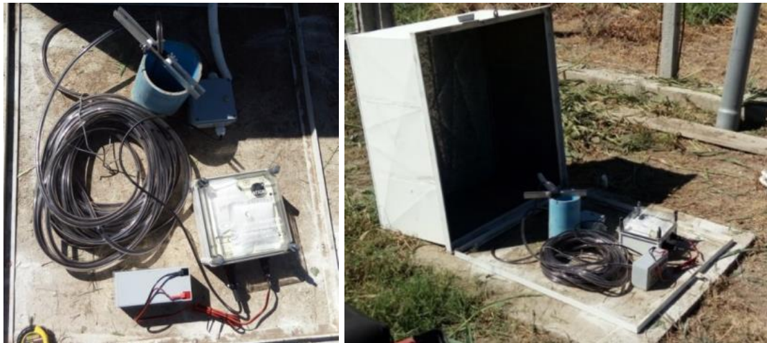
Foto 7. Limnógrafo instalado en la perforación de estudio de la estación hidrometeorológica de la localidad de Arata.
