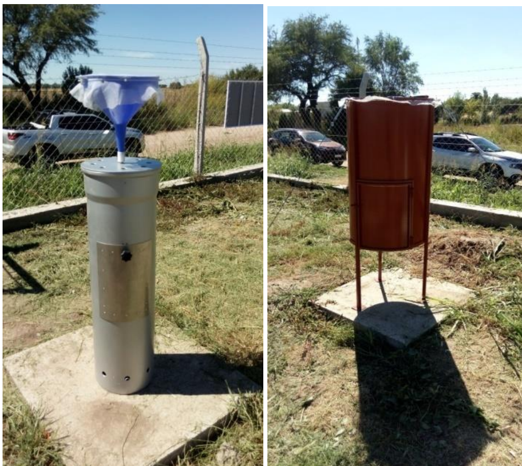
Foto 8. Colectores de agua de lluvia instalados en la estación hidrometeorológica de la localidad de Arata.
