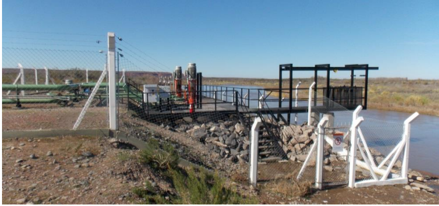
Foto 5.1 Planta de abastecimiento de agua para HCNC del río Neuquén. Foto: Sarandón, 2014.
